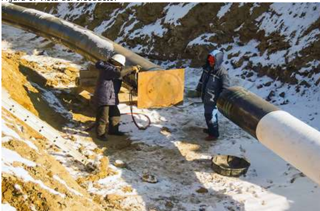
Figura 8. Vista del oleoducto.
