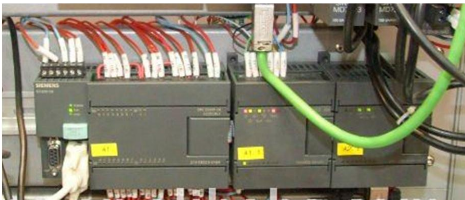
Figura 64. Controlador SIMATIC S7-200 y módulos de extensión EM231 y EM232.
