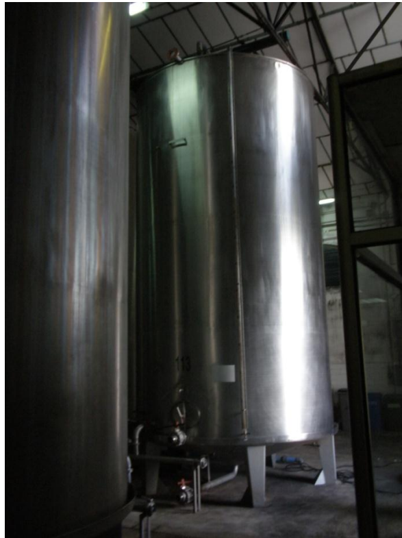
Figura 58. Depósito de la planta de fermentación de Beam Suntory en Jerez.
