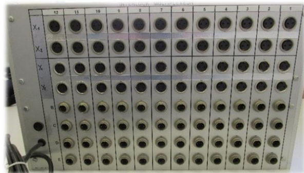
Figura 40. Panel trasero del rack de enclavamientos del MUX usado en el CPS mostrando los 12 canales, 2 por tarjeta.
