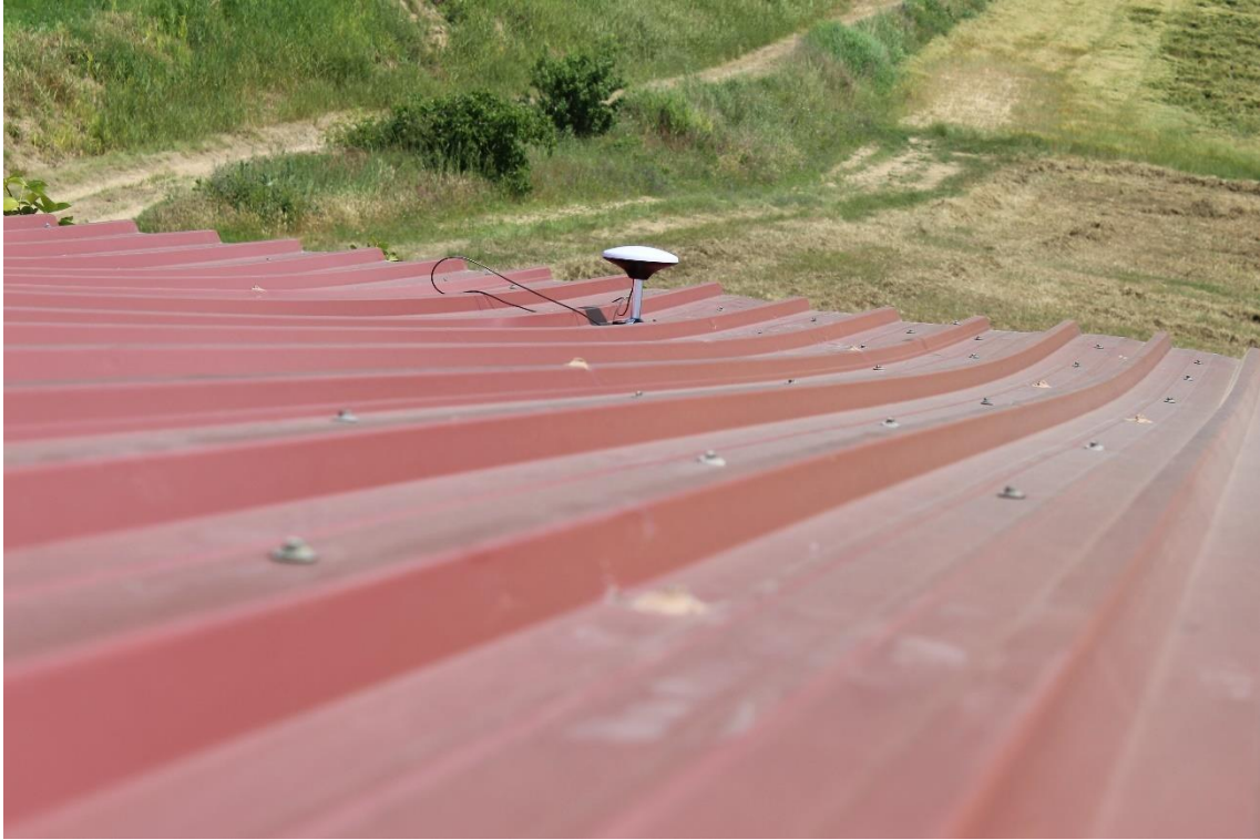
Figura 42 Detalle de las irregularidades del faldón del tejado
