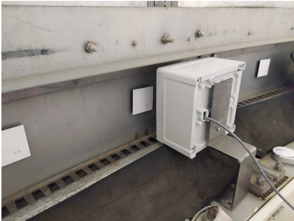
Figura 3.8: Instalación de lector RFID y tags en la cúpula. (Fuente: elaboración propia)
