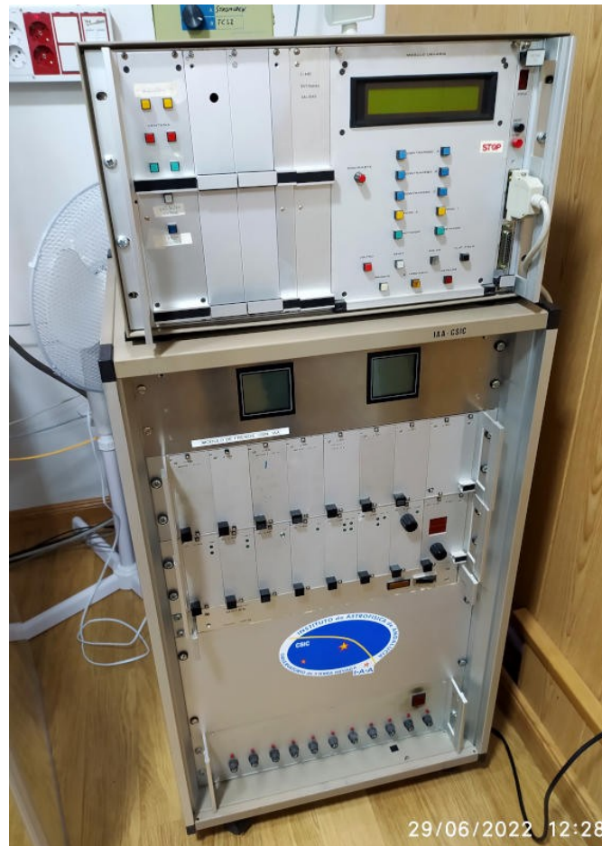
Figura 2.5: Sistema de control actual del telescopio T-90. (Fuente: elaboración propia)
