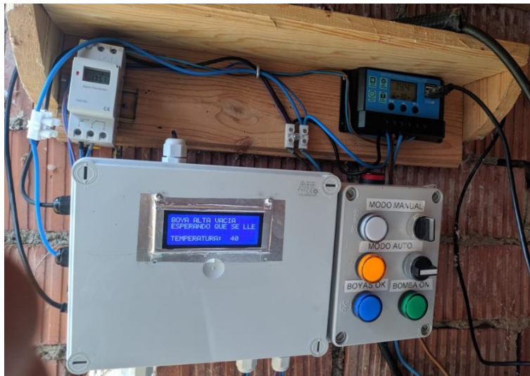
7 Sistema de extracción de agua
