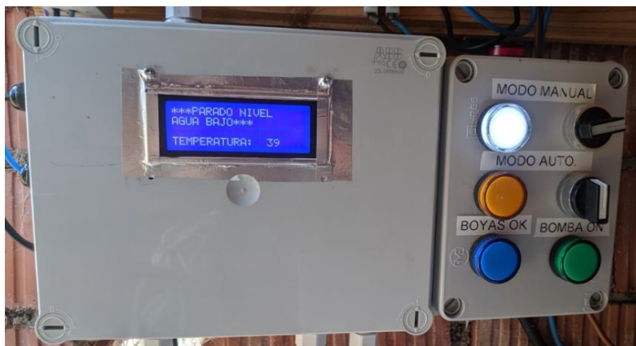
19 Sistema parado por nivel de agua bajo
