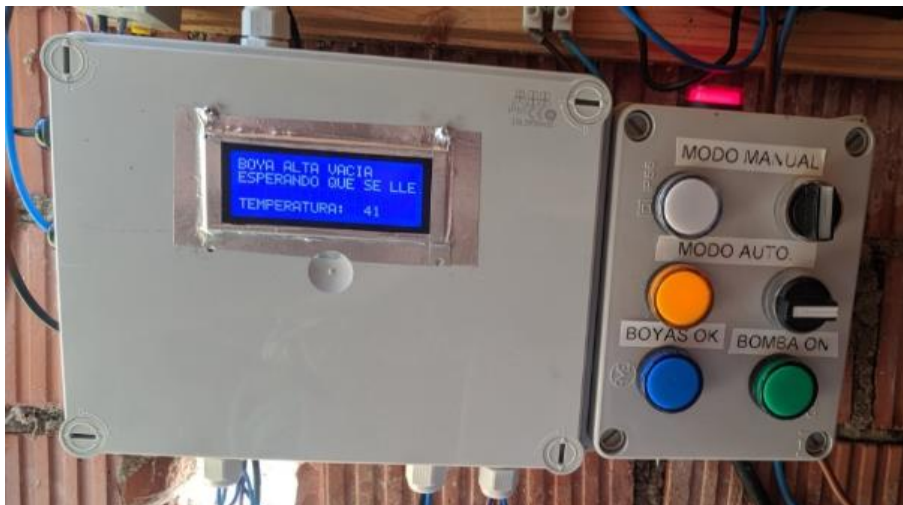
21 Sistema esperando que se alcance el nivel de agua óptimo
