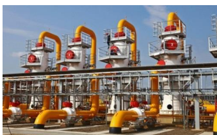
Figura 4.4. Estación de compresión de Sakhalin (Rusia).
