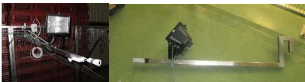
All 1 Instalación con un punto de luz y brazo extensible”
