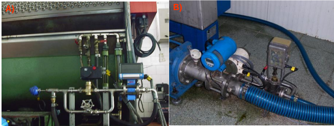
Figura 3. Dos circuitos reales de adición de agua al separador centrífugo horizontal
