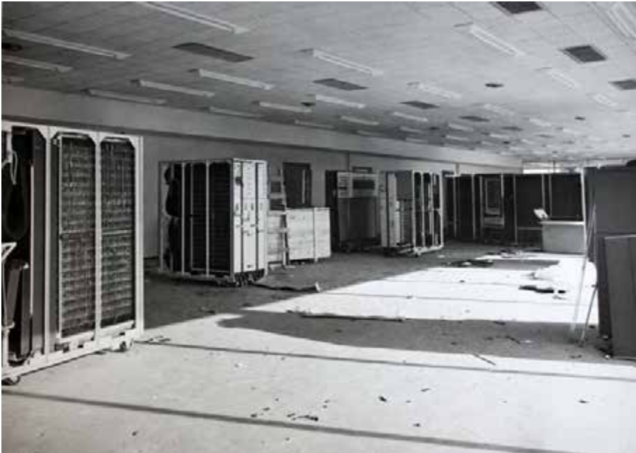
Figura 3. Instalación en la Sala de máquinas.
