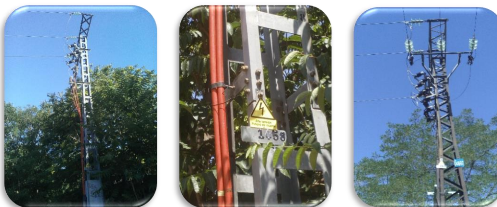
Figura 7. Fotografías de algunos de los tendidos eléctricos situados en el interior del Campus de Moncloa. Como se puede observar en la fotografía central, se corresponden con líneas eléctricas de alta tensión. Los aislantes rojos descendentes en las dos primeras imágenes, probablemente bajen los conductores para que continúen su camino bajo tierra (Fotos: Alfonso Balmori-de la Puente).
