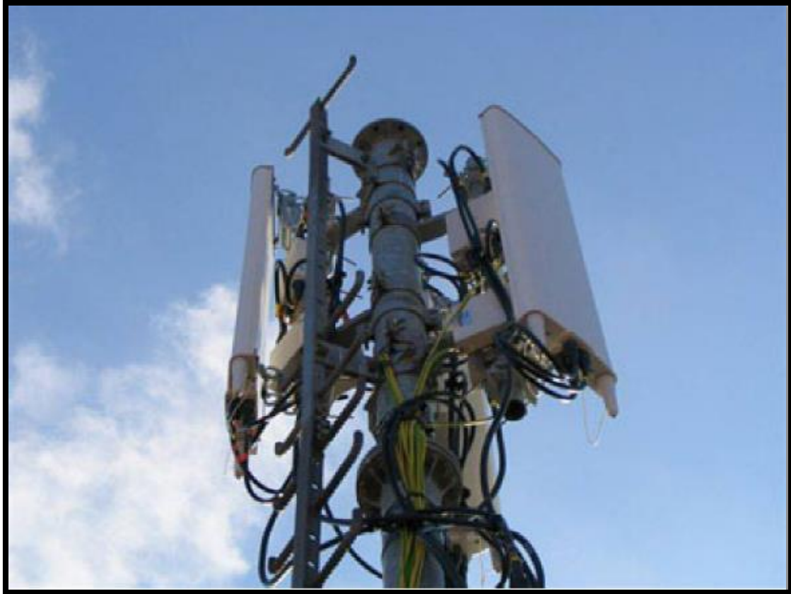
Figura 8. Primer plano de una estación base estándar de telefonía móvil (Fuente: César Balmori).
