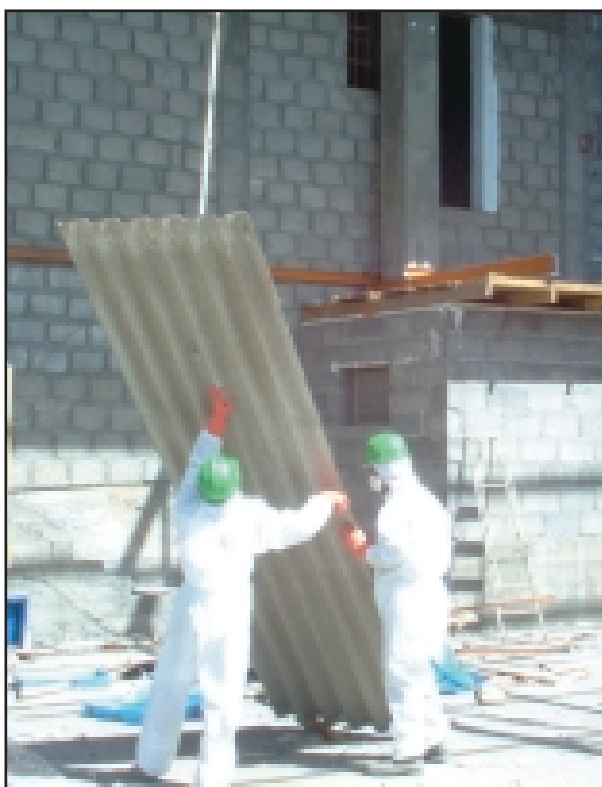
FOTO 7.- LAS PLACAS DE FIBROCEMENTO DEBEN DE TRATARSE CORRECTAMENTE PARA EVITAR SU ROTURA.
