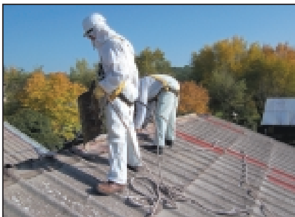
FOTO 6.- OPERARIOS PERFECTAMENTE EQUIPADOS TRABAJANDO CON FIBROCEMENTOS.
