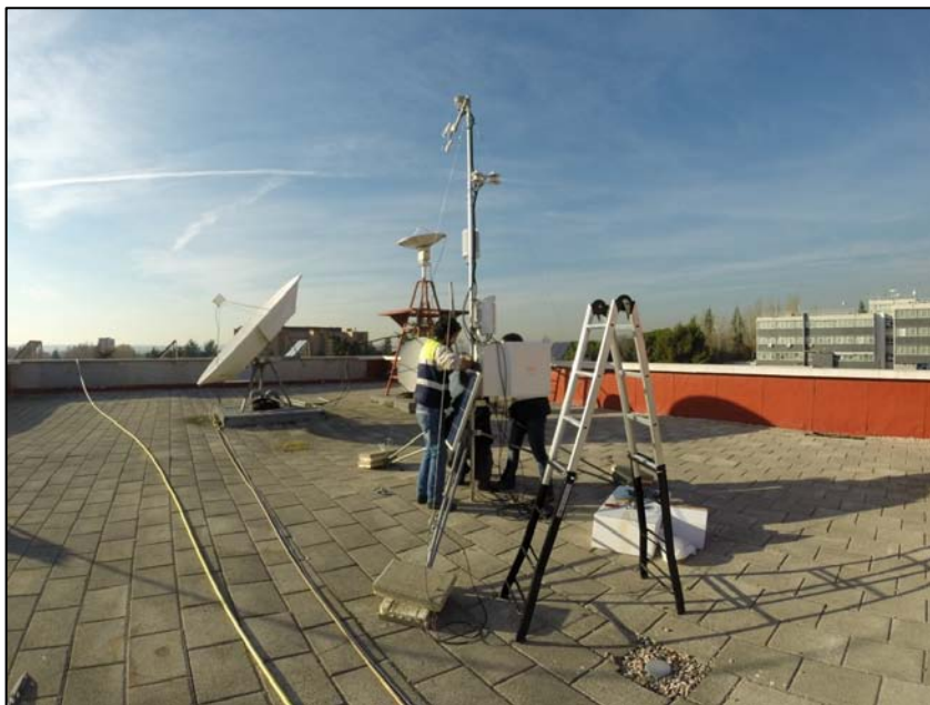
Figura 6. Instalación de estación EG901-Portatil
