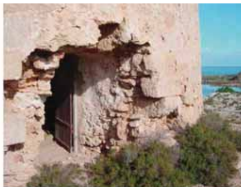
Fig. 12. Vista de la puerta sin restaurar
