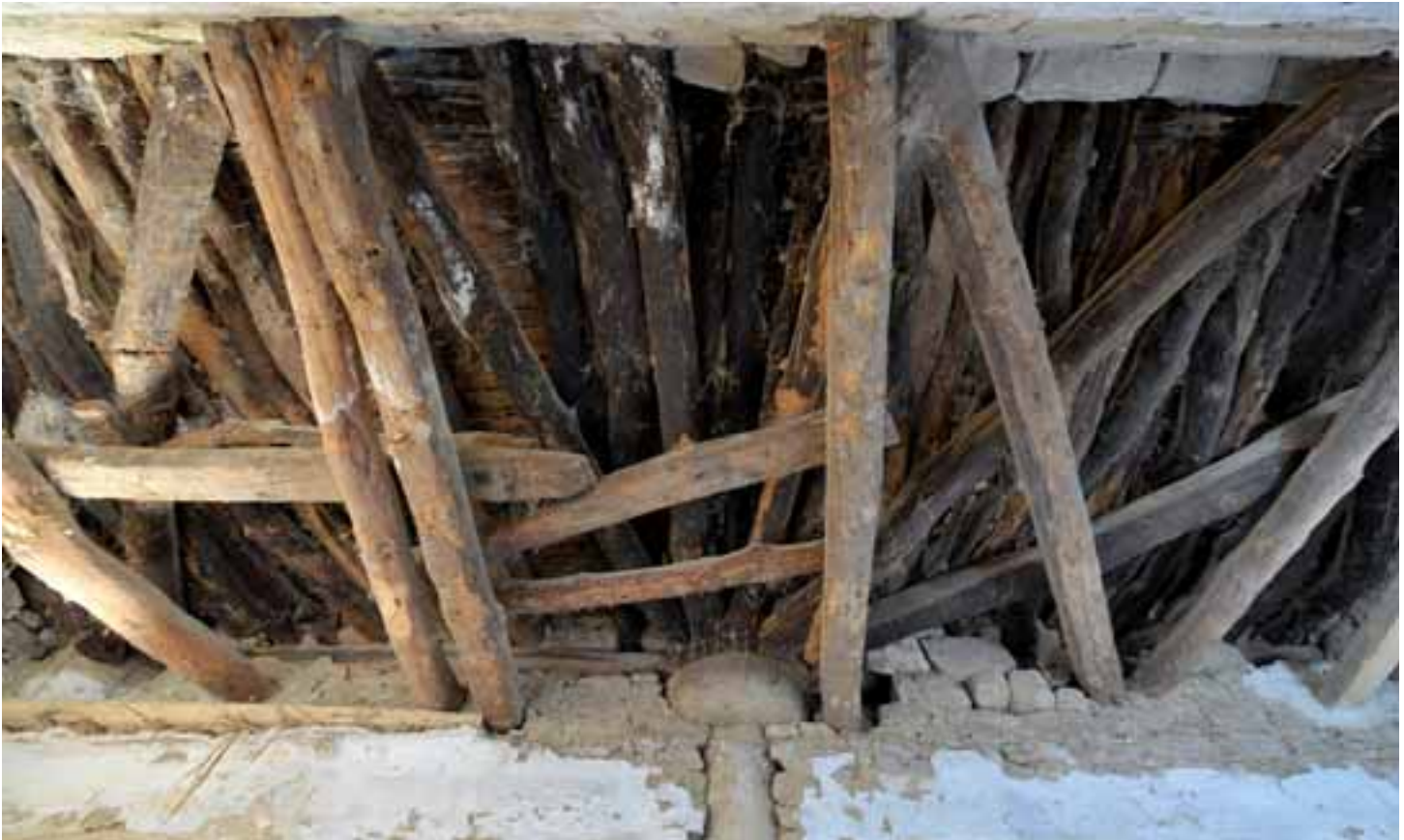
Estructura lignaria radial de la casa situada delante de la fachada meridional
