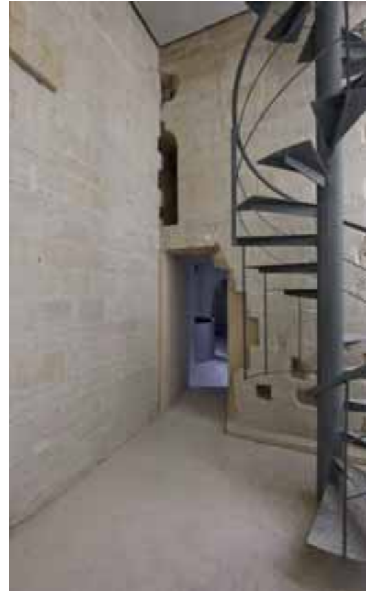
Contrafuerte gótico que se entrega contra la ventana románica de la torre
