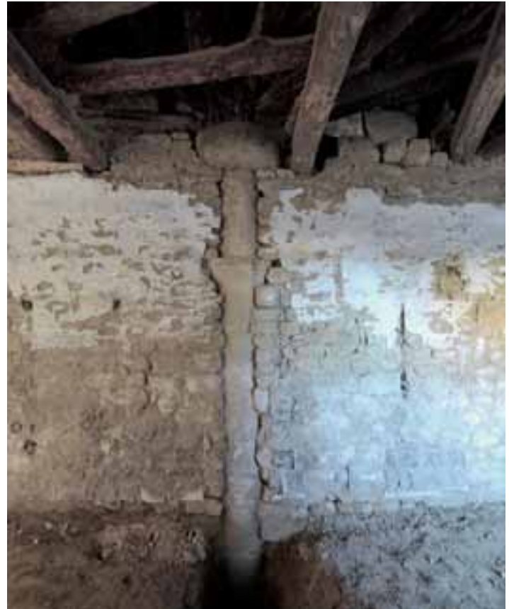
Interior de la casa situada delante de la fachada meridional antes de la intervención
